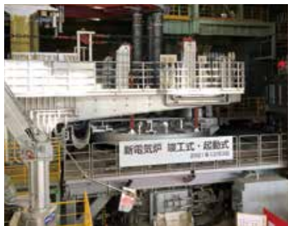
新電気炉の炉体
