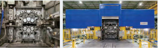
新冷間圧延機ハウジング内部 新冷間圧延機
