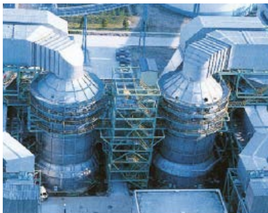
石炭火力発電所排煙脱硫装置
