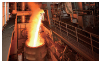
新電気炉(E炉)
