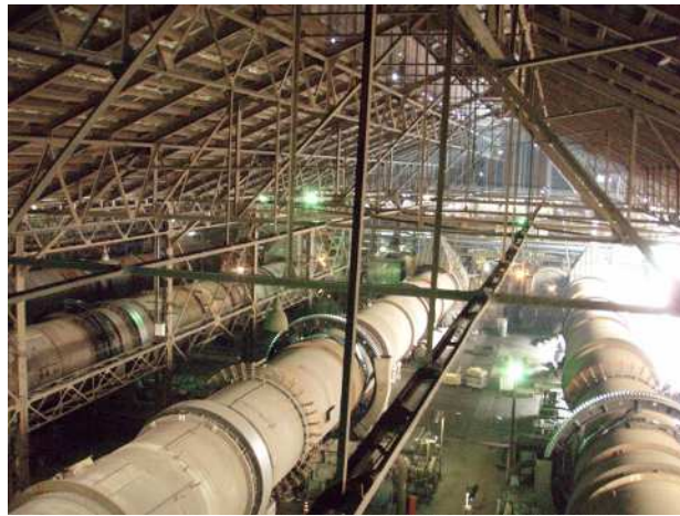
大江山製造所ロータリーキルン全景
