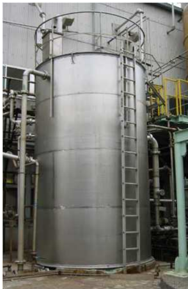
NAS254N 製食塩スラリータンクの外観
