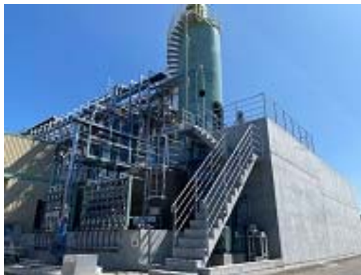
写真：川崎製造所排水処理場に完成した新処理設備
