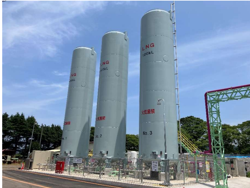
完成した LNG サテライト設備（敷地内で貯蔵）
