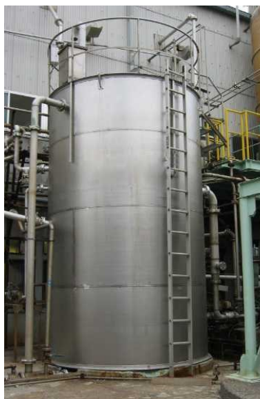
NAS254N 盐浆罐外观
