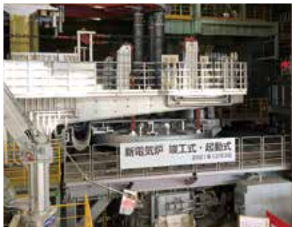
新電気炉の炉体
